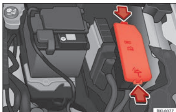
Fig. 70 En el vano motor: tapa de la caja de fusibles.
